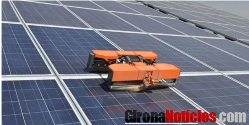
Plaques solars fotovoltaïques
