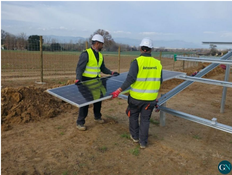
Planta solar fotovoltaica 'El Pla de la Font'
